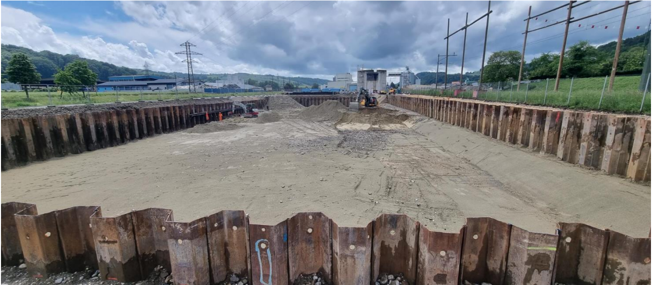
Enceinte de palplanches et terrassement pour les bassins de traitement biologique, vue depuis le nord, en direction de Lucens
