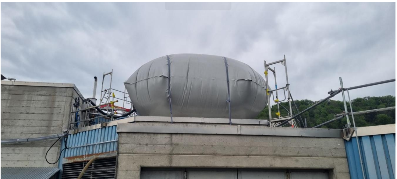
Installation provisoire de stockage de biogaz, sur le toit du bâtiment de service
